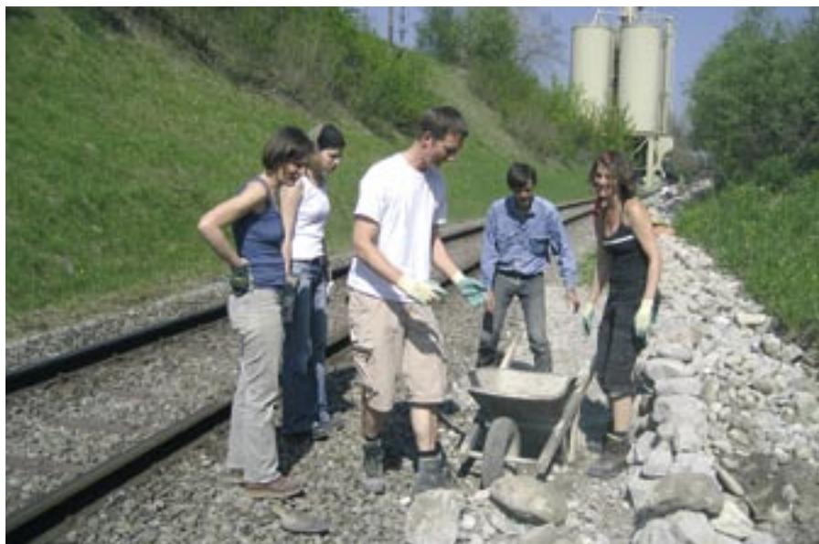
■ UBS Mitarbeitende beim Arbeitseinsatz in einer Kiesgrube. ■ Des employés d'UBS au travail dans une gravière. Texte français sur page 26. ■ I collaboratori dell'UBS al lavoro in cava.
